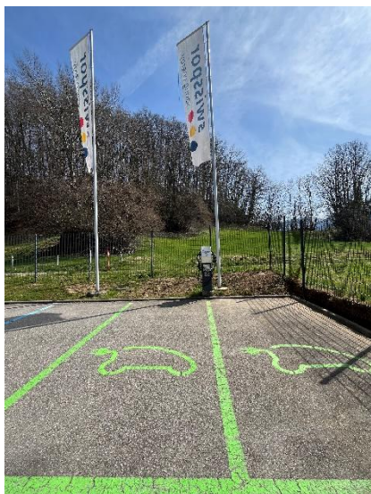
Figure 3 : Borne électrique de Châtel I
