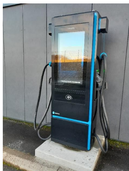
Figure 6 : Borne électrique de Châtel II
