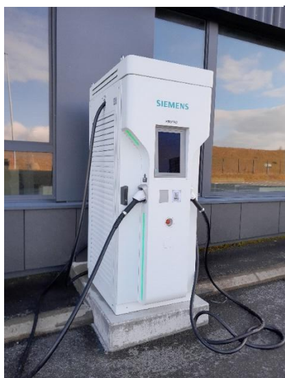
Figure 5 : Borne électrique de Châtel II
