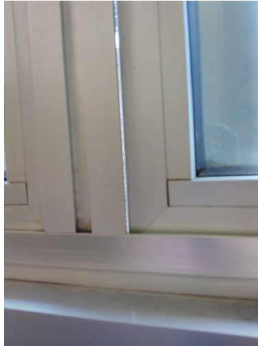
Container vestiaire : fenêtre plus étanche
