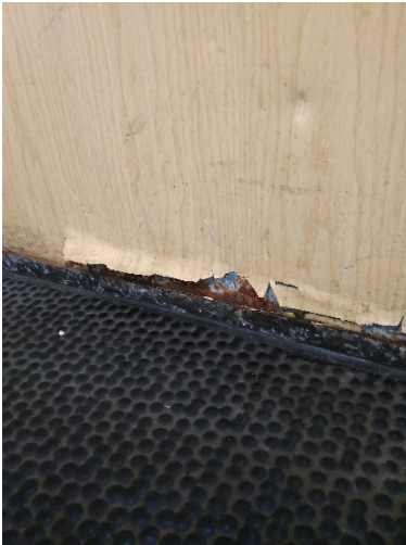
Container vestiaire : usure sol et paroi
