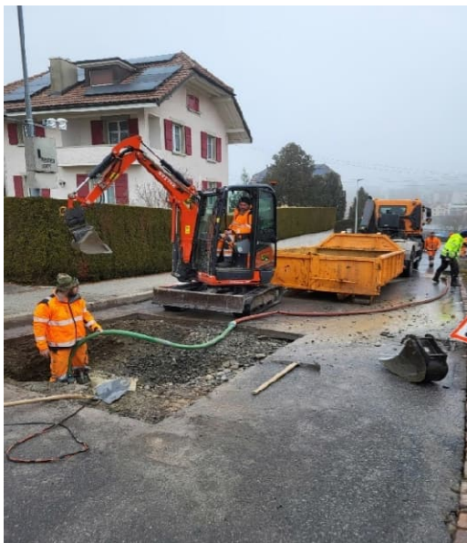
Champs-Thomas : fuite sur conduite FD 100mm
