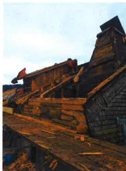
Charpente chalet La Bria en très mauvais état
