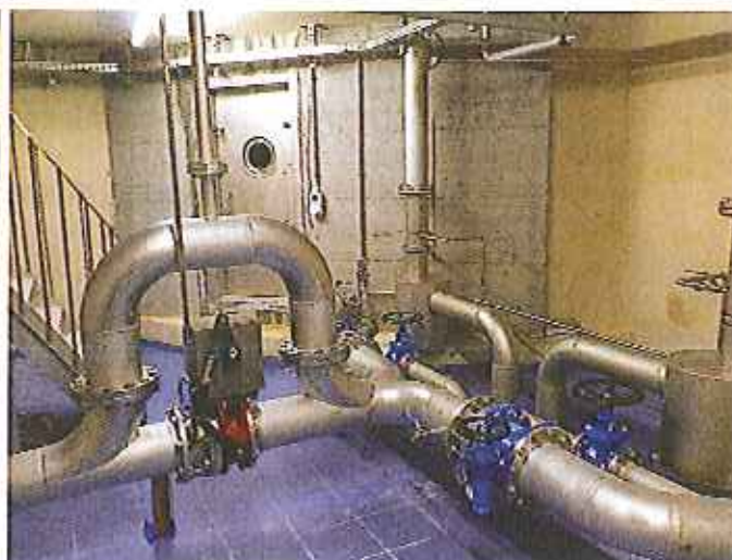
Réservoir Maudens Installation sous-sol
