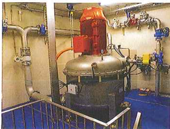
Réservoir Maudens Turbine à contre-pression. Mise en service le 29.11.12
